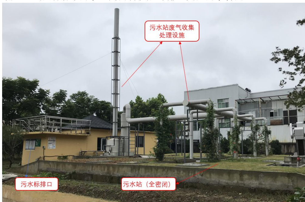
图3-2 母公司污水站及其废气收集处理设施照片
